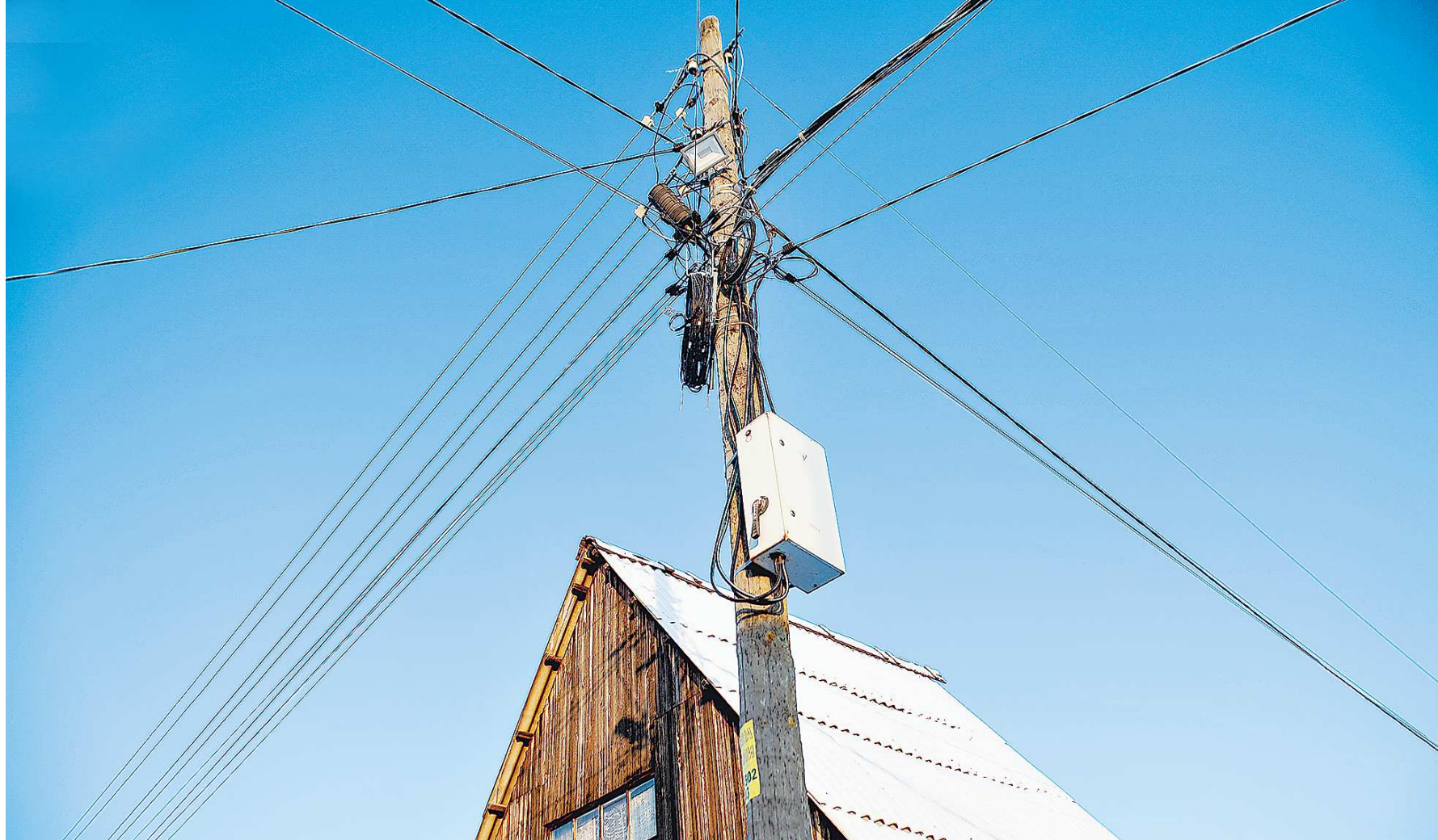
Ветхие деревянные столбы с путаницей проводов, установленные к тому же вплотную к домам, – типичная картина во многих садоводческих товариществах
