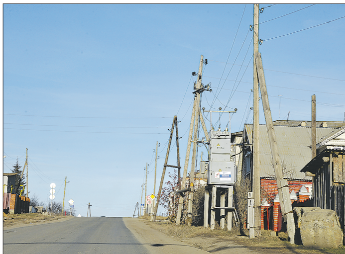
Электросетевое хозяйство в Ивдельском ГО нуждается в серьёзной реконструкции, признают чиновники
