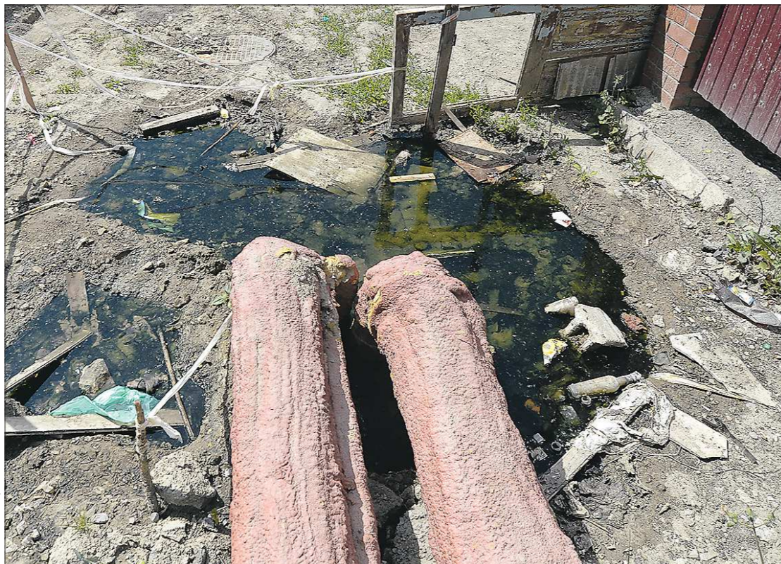
Вот так выглядит аварийный участок сети ГВС по улице Механизаторов в Позарихе
