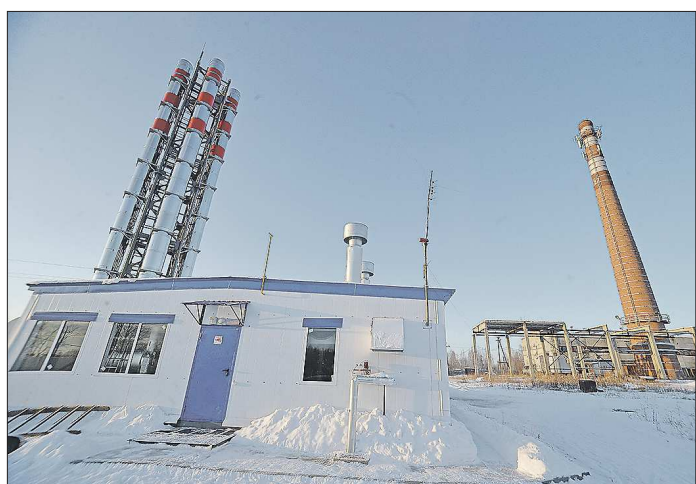
В Волчанске две газовые котельные позволили уйти от издержек по эксплуатации огромной старой котельной, которая обслуживала не только жилой фонд, но и ныне неработающее предприятие по добыче угля
