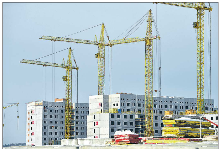
Общая площадь пяти общежитий составит почти 210 000 квадратных метров. Жилых комнат в каждом здании будет 870
