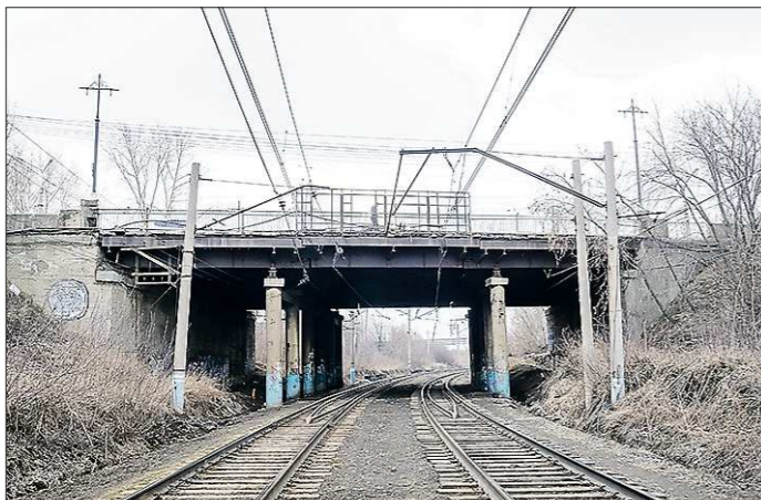
Почти все мостовые опоры необходимо менять – за годы эксплуатации они износились
