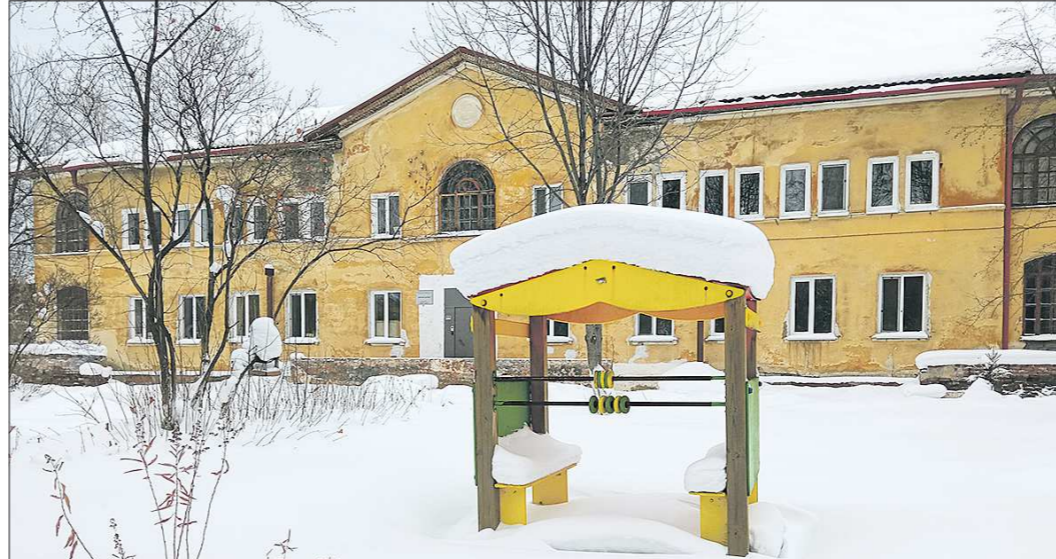
Время от времени в старом здании детсада проводились ремонты: меняли окна, латали крышу, но капитальных вложений не было со дня постройки
