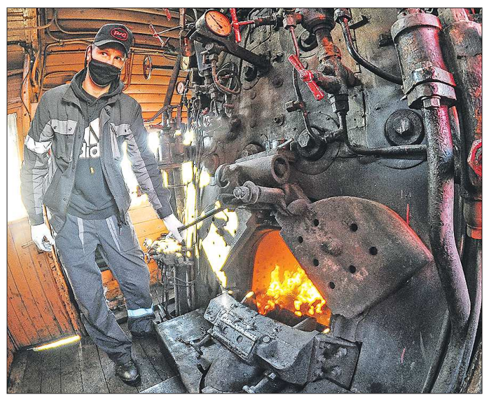
Уголь в топку паровоза для поддержания необходимого давления и температуры в котле нужно подбрасывать каждый час
