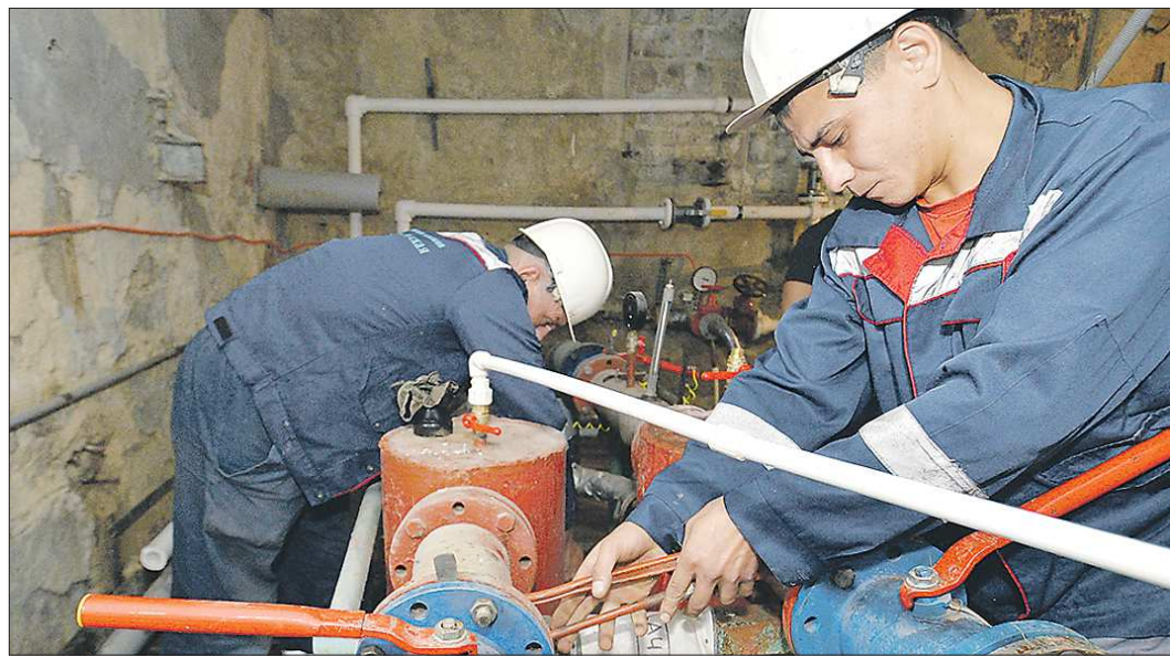
Сейчас в Каменском районе работают 6 угольных и 12 газовых котельных. Они давно нуждаются в ремонте
