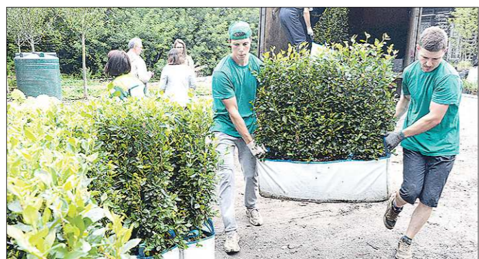
В будущих садах вовсю кипит работа. Все привезённые сюда растения – с закрытой корневой системой. Например, этот кизильник станет живой изгородью
