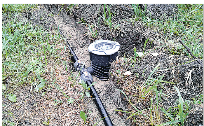
Подземная водозаборная колонка: после того, как её закопают землёй, на поверхности останется только крышка
