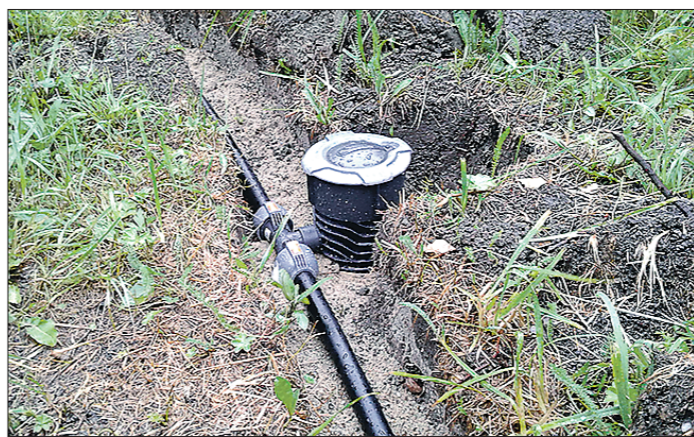
Подземная водозаборная колонка: после того, как её закопают землёй, на поверхности останется только крышка
