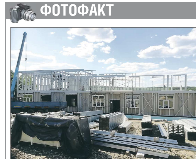
В посёлке Косья Нижнетуринского городского округа на глазах растёт новое здание, в котором разместится школа и детский сад. Рабочие уже приступили к возведению второго этажа.
