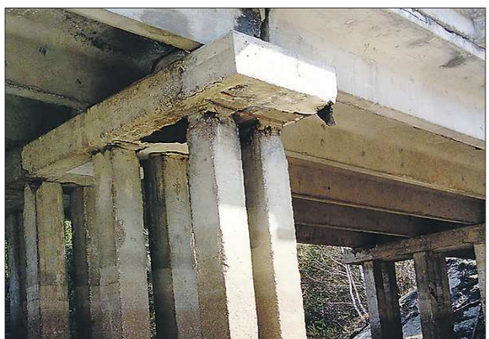
Из-за постоянной нагрузки опорные конструкции моста «разъехались», их будут менять
