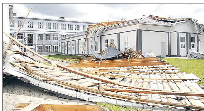
Крышу со здания спортзала школы №7 в Сухом Логе ветром снесло на землю и на крышу столовой
