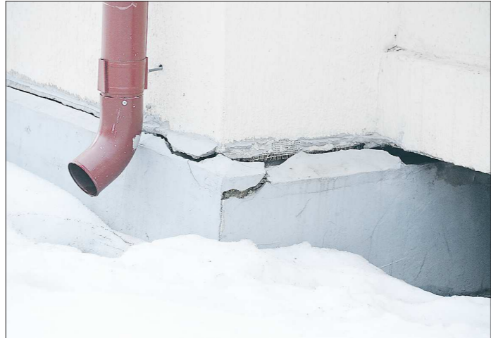
Вот такие трещины можно увидеть в отмостке дома №14а по улице М.Горького
