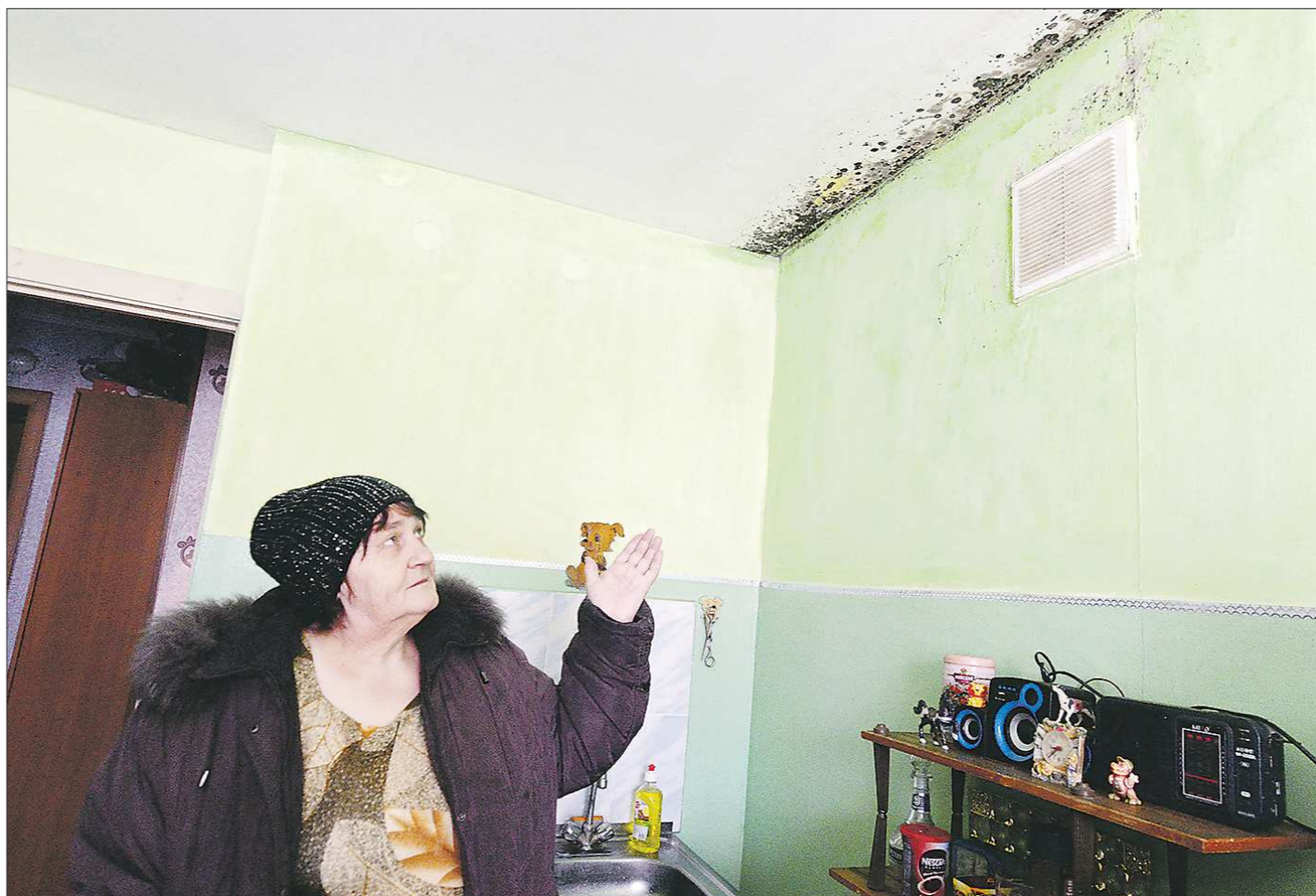
Вот с таким грибом на стенах вынуждены жить карпинцы в домах по улице Советской, 113
