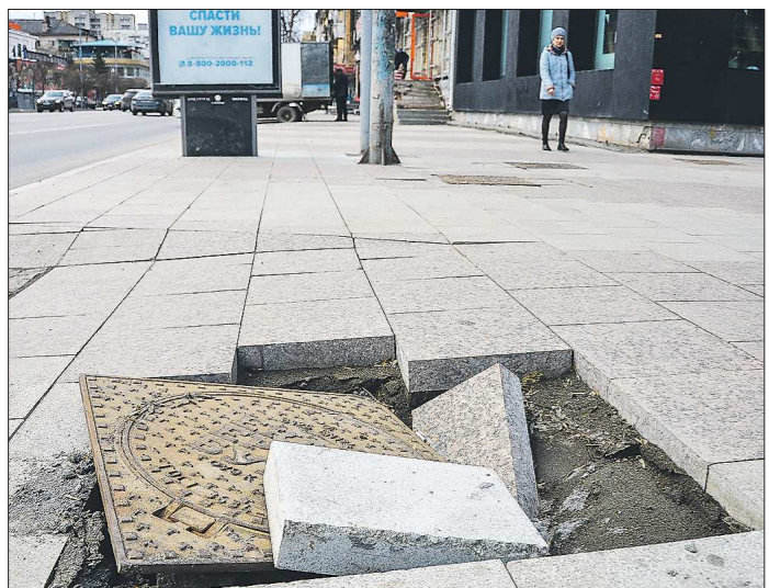
Люк с разбитой плиткой на перекрёстке Малышева – Бажова
