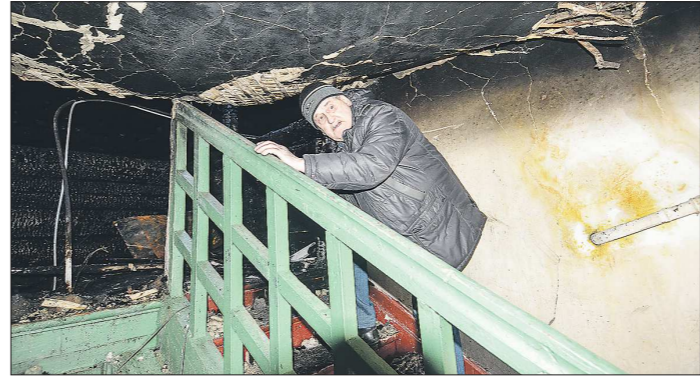
Житель дома по ул. Авангардной, 7 Геннадий Михайлович показывает последствия пожара на чердаке
