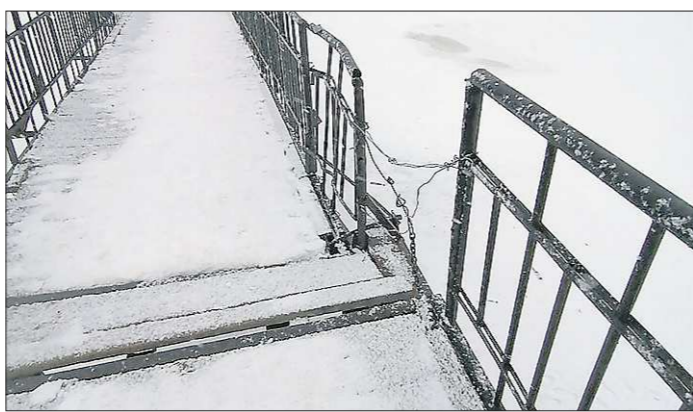
Ходить по разрушающемуся мосту опасно, а зимой ещё сложно и скользко
