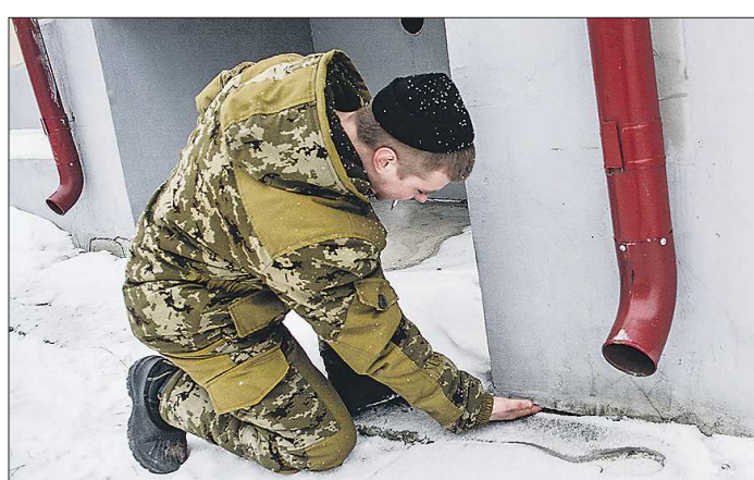
Жители дома №14а по улице Максима Горького – Иван – осматривает трещины в фундаменте
