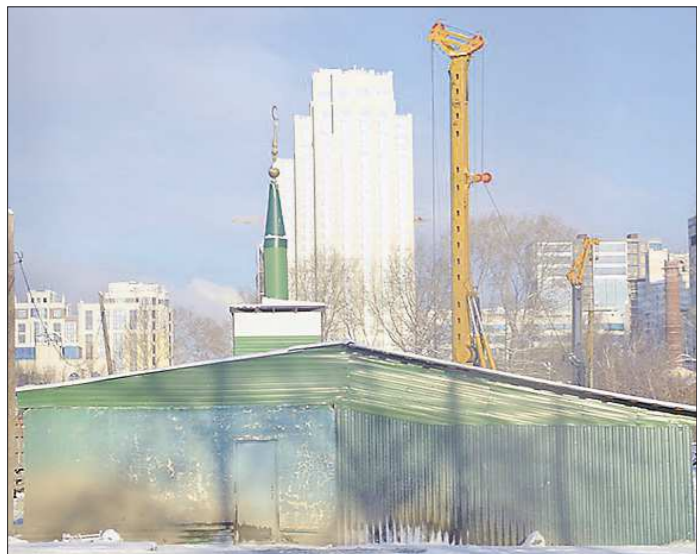
На территории, где находится временная мечеть «Нур-Усман», возведут ледовую арену. Строительные работы уже идут
