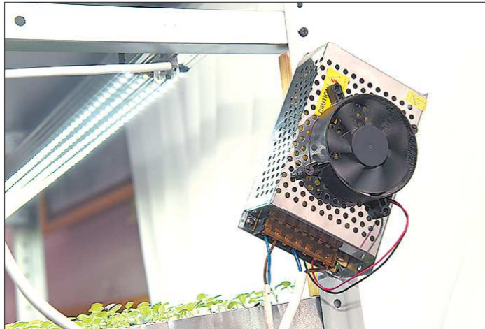
Блок питания для светодиодной ленты Алексей Никитин дополнил вентилятором, взятым от обычного компьютера
