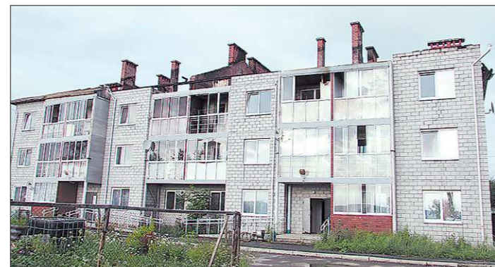
Пожар на верхнем этаже уничтожил не только имущество жильцов и их квартиры, но и крышу дома. Благо обошлось без жертв
