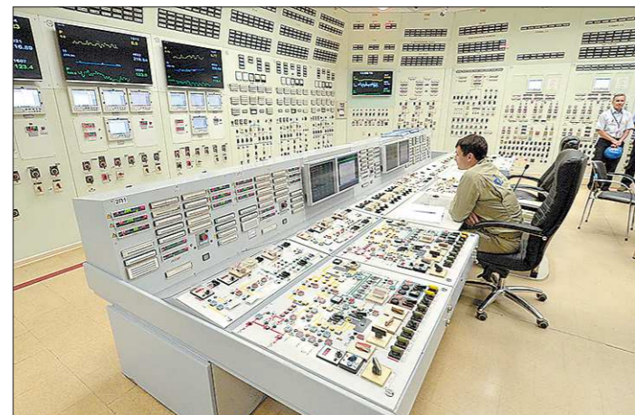
Блочный щит управления третьего энергоблока Белоярской АЭС. Именно сюда стекается информация о каждом элементе большого организма блока
