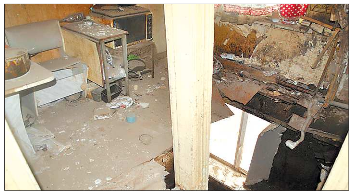
В программу переселения из ветхого и аварийного жилья дом не попал. Хотя сейчас он точно подходит по всем параметрам
