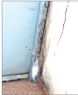
В Речалковском ФАПе спустя полтора года после ремонта появилась плесень
