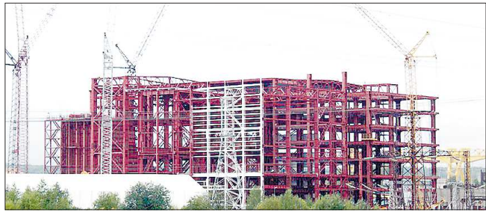
Ввод нового энергоблока на Верхнетагильской ГРЭС позволит вывести из эксплуатации устаревшее неэкономичное угольное оборудование
