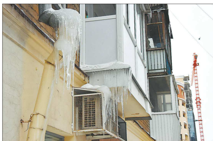
В Екатеринбурге чуть ли не каждый дом, построенный до 90-х годов, — пример того, как балконное остекление противоречит изначальному архитектурному облику здания
