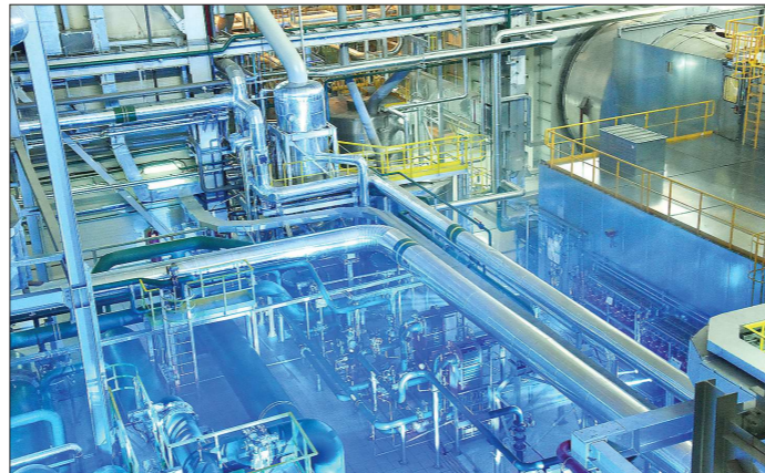
Электрическая мощность ТЭЦ — 230 МВт, тепловая — 403 Гкал/ч. Тепло можно будет обеспечить более 300 детсадов, 210 школ и свыше 200 многоэтажных домов
