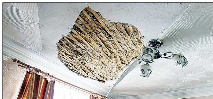
Штукатурка в североуральской квартире обвалилась поздно ночью. Жильцы чудом не пострадали
