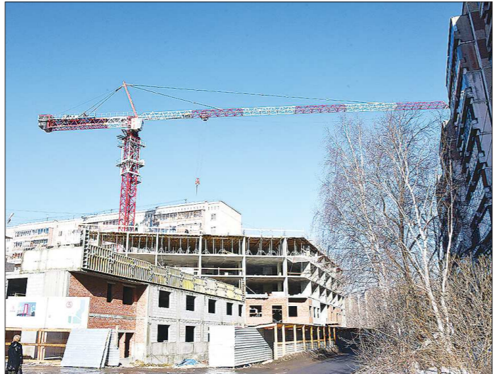
Новые здания в Екатеринбурге возводятся прямо во дворах так, что краны нависают над жилыми домами
