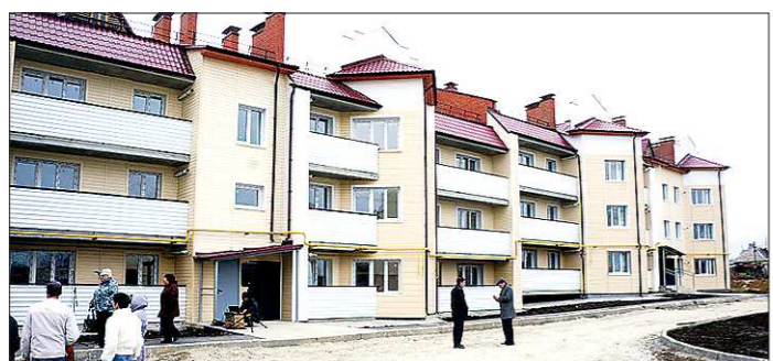
При заселении жильцы дома обнаружили единственный его недостаток — удалённость от центра Карпинска. Спустя несколько месяцев в квартирах появились проблемы посерьёзнее
