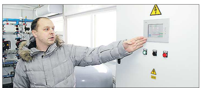
Главный инженер МУП «Тепловые сети» Сергей Воронин указывает на данные работы котельной, которые поступают не только в диспетчерский пункт, но и производителю оборудования в Чехии
