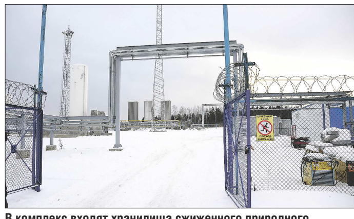
В комплекс входят хранилища сжиженного природного газа, узел регазификации, где путём испарения из жидкого состояния топливо переходит в газообразное, и трубопровод, подающий газ на котельные
