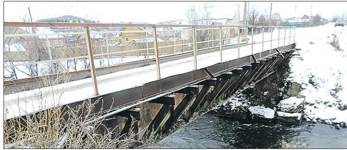
Фундамент моста размывало ежегодными паводками, и теперь одна из опор находится в неудовлетворительном состоянии
