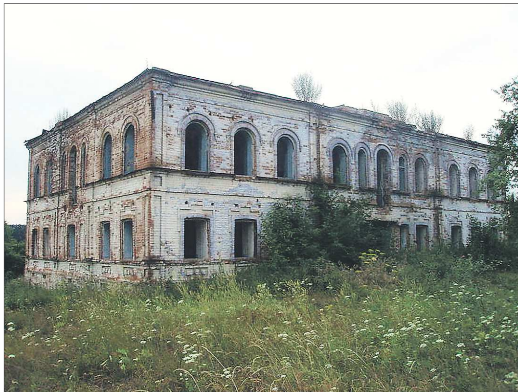
Башкарская школа (Горноуральский городской округ) переехала из исторического здания 36 лет назад: новых хозяев особняк так и не нашёл
