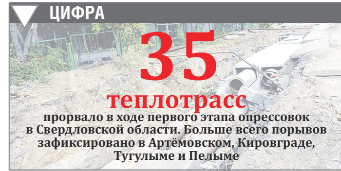
35 теплотрасс прорвало в ходе первого этапа опрессовки в Свердловской области. Больше всего порывов зафиксировано в Артёмовском, Кировграде, Тугульме и Пельяме
