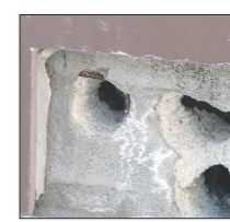
По словам министра, в подвалах домов на улице Лермонтова были сделаны дополнительные технологические отверстия, которые увеличили приток свежего воздуха. Помогут ли такие меры?
