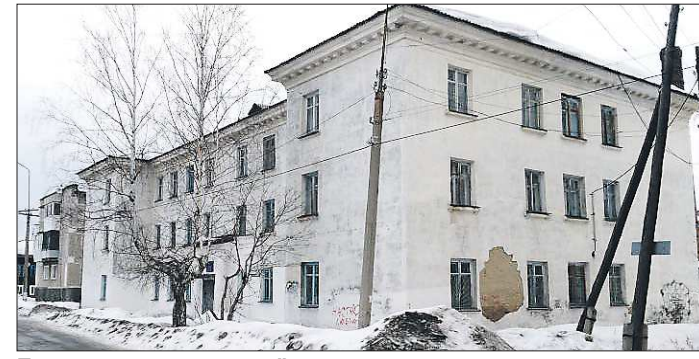
Подготовили здание ещё в прошлом году — студентов переселили в другое общежитие, а в этом металлургический завод сделал минимальный ремонт
