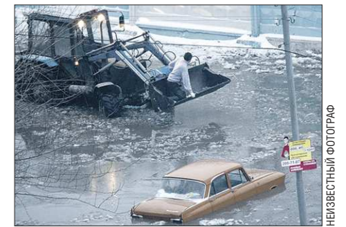
Движение по улице Крестинского перекрыли, а на месте аварии работали аварийные бригады
