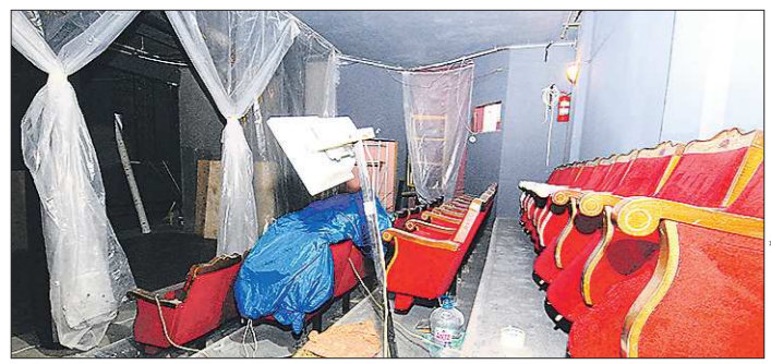
Больше всех из помещений театра пострадал зрительный зал. Теперь остаётся надеяться, что отсыревшие стены благополучно переживут суровую уральскую зиму и дотянут до капитального ремонта
