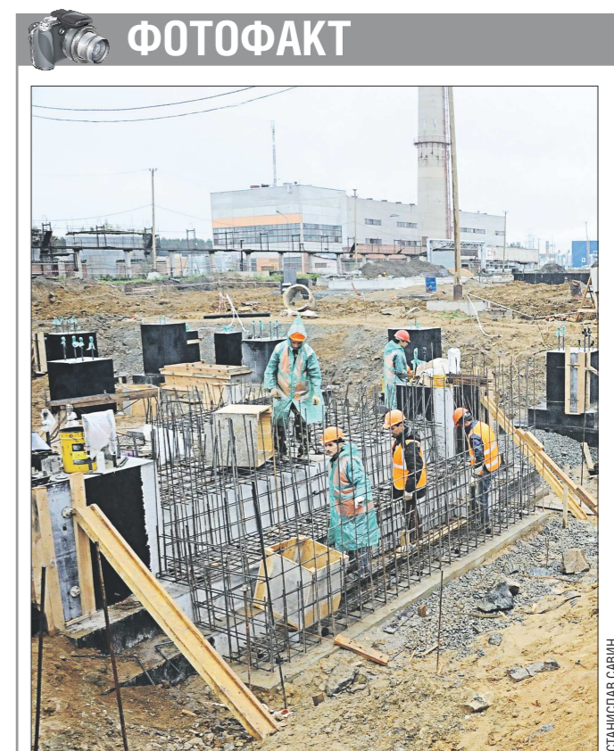
К концу нынешнего года будет сдана первая очередь паргазовой ТЭЦ «Академическая», полное завершение строительства которой запланировано на 2016 год. Вчера стройплощадку осмотрели председатель правительства Свердловской области Денис Паслер и гендиректор ЗАО «Комплексные энергетические системы» Борис Вайнзихер. Они отметили, что работы идут по графику. Реализация этого инвестиционного проекта стоимостью более десяти миллиардов рублей, ведущаяся на средства ОАО «ТЭК-9», позволит ускорить развитие юго-западной части Екатеринбурга
