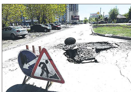
Строительство коммунальной сети, очевидно, «провалилось»
