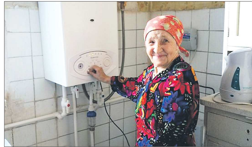
86-летняя жительница Карпинска Марию Васильевну Воронцову теперь не приходится спозаранку растапливать печь — в её в квартире есть горячая вода и отопление
