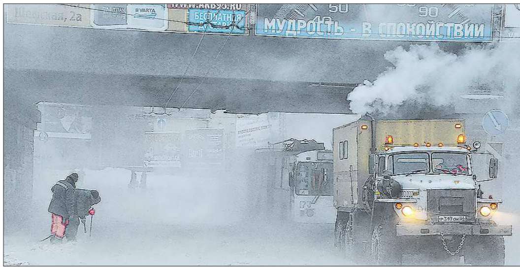
Повреждённый в Екатеринбурге водопровод диаметром 150-200 мм сейчас отключён. В устранении последствий утечки были задействованы пять аварийных бригад, шесть экскаваторов, три самосвала и насос на базе трактора «Беларусь»
