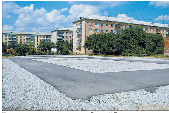
На месте детского автогородка в Верхней Пышме осталось лишь «круговое движение». Согласно проекту, здесь должны появиться горки, качели, баскетбольная площадка... Обещанного преобразования двора жители ждут уже год
