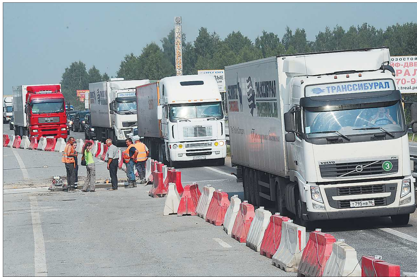
По словам мастера, ремонт идёт по графику: рабочие трудятся до семи вечера и намерены привести дорогу в порядок даже в выходные
