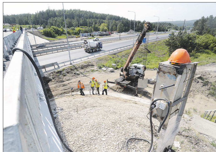
Партии проверили работы на нескольких объектах, в том числе на региональной автодороге Семь Ключей - Большой Исток
