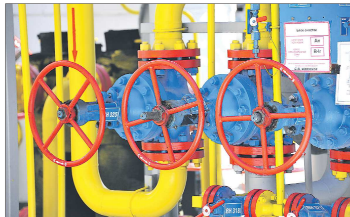
Установка на ГРС-4 Екатеринбург производит три тонны СПГ в час
